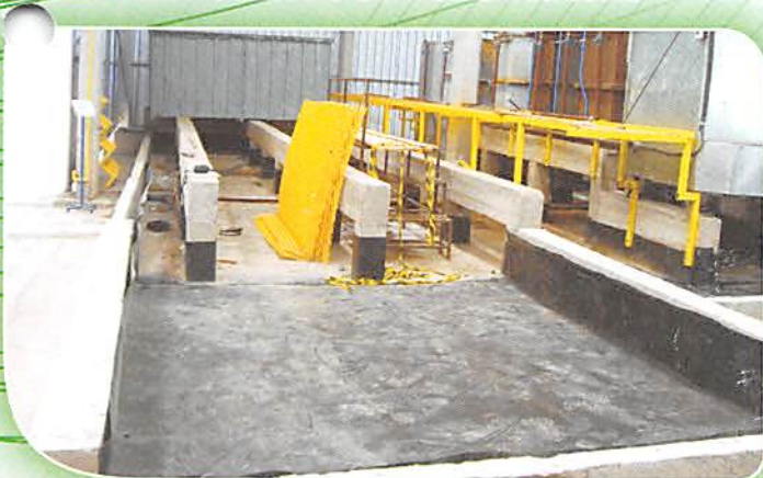
ÁREA DE PINTURA INDUSTRIAL
