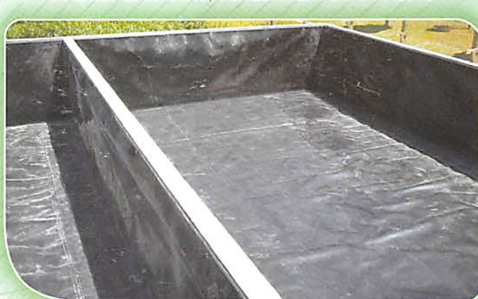
CISTERNAS DE ALVENARIA, REVESTIDAS COM GEOMEMBRANA
