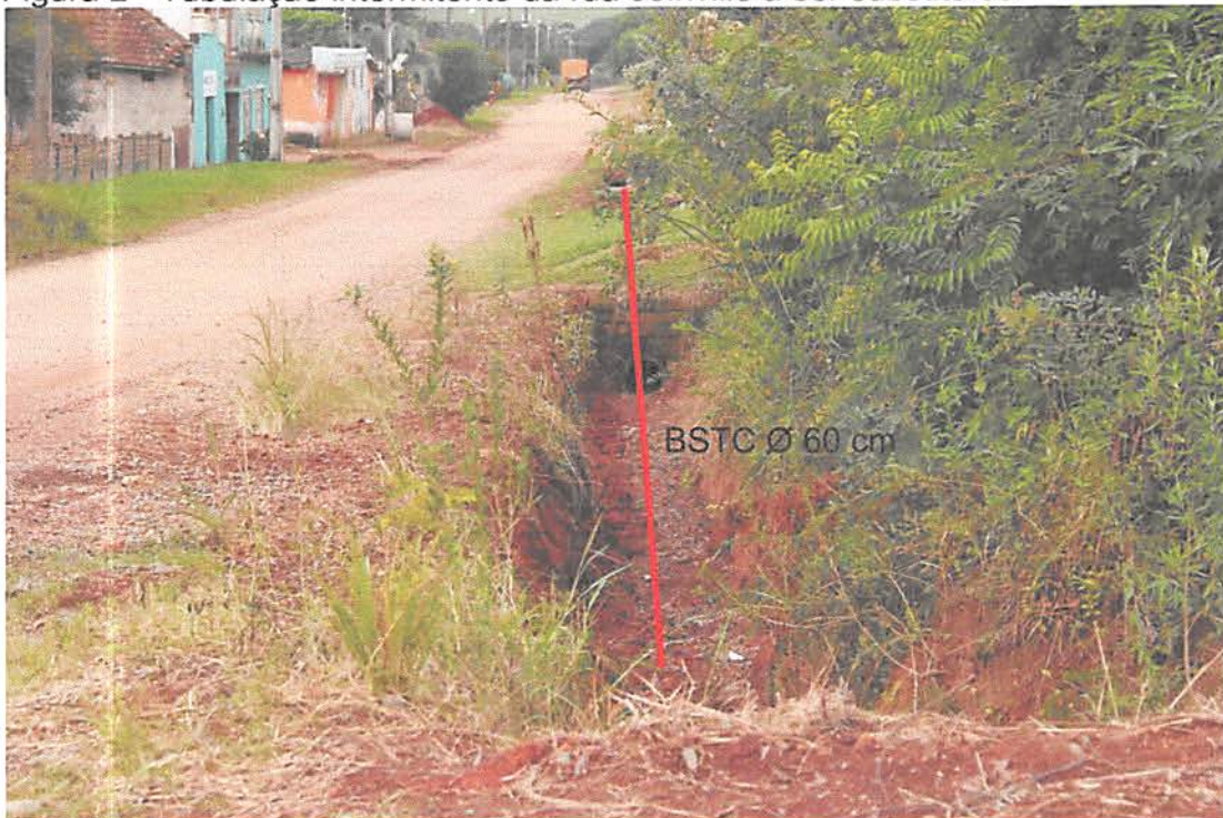
Figura 2 - Tubulação intermitente da rua Joinville a ser substituída
